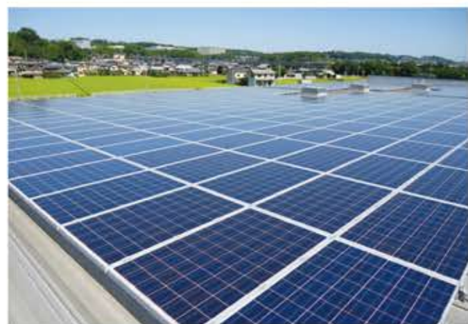
都窪郡 94.05kW (設置面積 約780m 2 )
