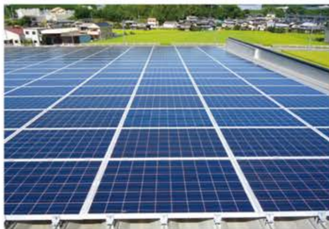
岡山市 82.08kW (設置面積 約600m 2 )
