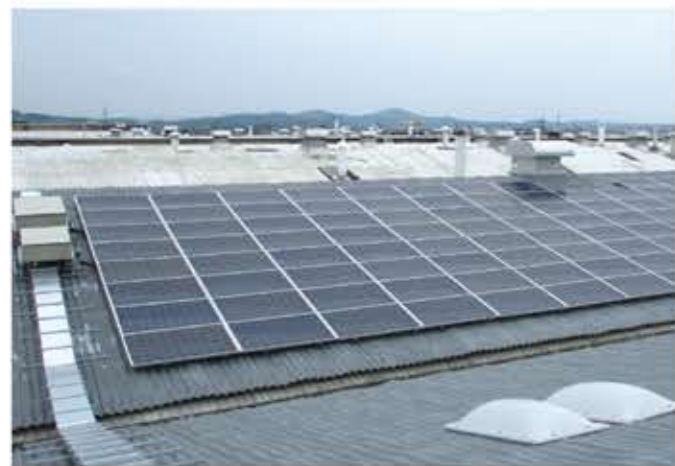
倉敷市 102.6kW (設置面積 約800m 2 )
